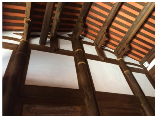
圖 8 第二進隔間牆架扇現況
