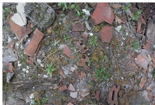
圖 2-2-8 門廳地坪堆積厝頂塌坍下的磚瓦 拍攝日期:2022.01.21
