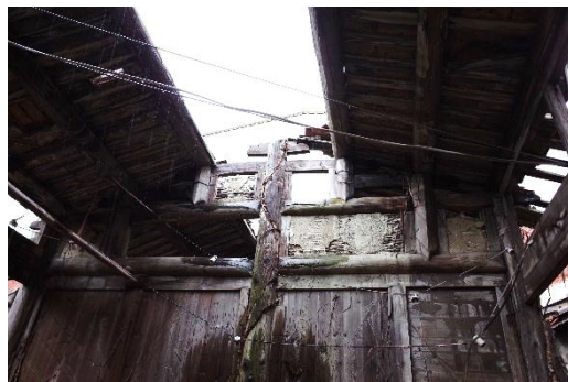
圖 2-2-45 第一進中脊佚失 拍攝日期:2022.01.21
