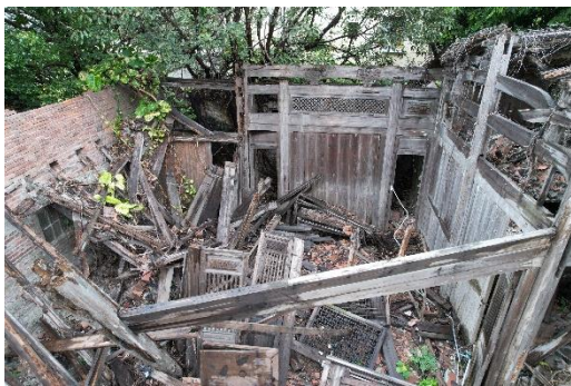
圖 2-2-44 第二進桁木佚失 拍攝日期:2022.01.21
