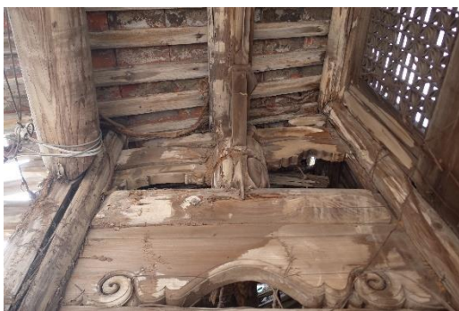
圖 2-2-37 第二進大廳簷廊(目前已坍塌) 拍攝日期:2020.05.01
