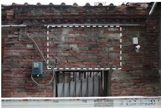
圖 2-2-34 第一進牆面修補痕跡 拍攝日期:2022.01.21
