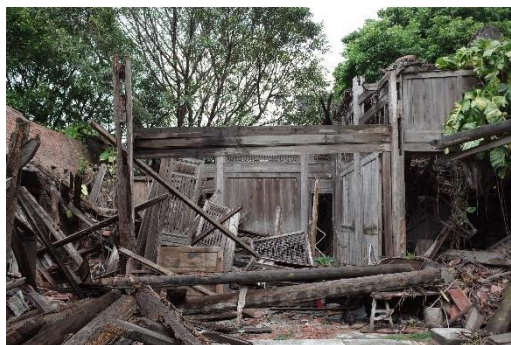
圖 2-2- 41 大廳簷廊坍塌 拍攝日期:2022.01.21
