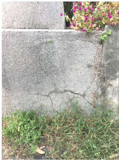
圖表 62：基座側面洗石子面層橫向龜裂痕跡
