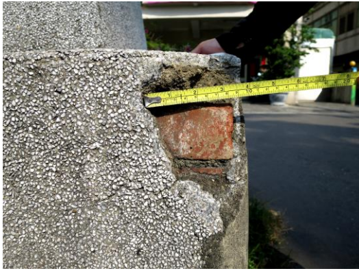
圖表 60：碑體基座（正面）破壞現況
