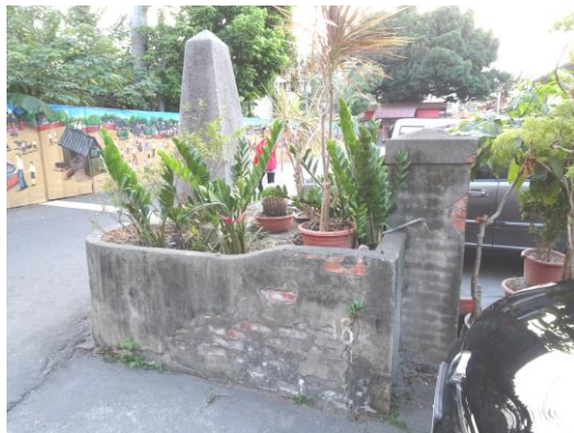
圖表 65：花臺與門柱表面水泥粉刷層缺損、剝落
