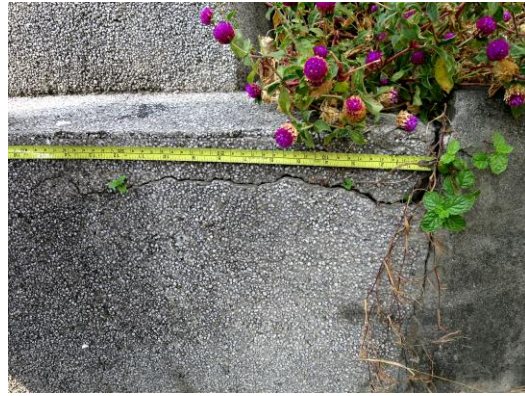
圖表 61：碑體基座（側面）橫向裂痕
